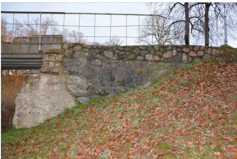
2.3.7. att. Balsta Nr.6 fasāde no augšteces puses. Balsta dekoratīvais laukakmeņu apbetonējums izjūk. Piebetonētās daļas ārmalā betons sabrūk, atsedzies stiegrojums korodē
