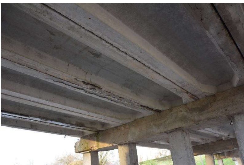
2.2.5. att. Laiduma konstrukcijas plātņu bojājumi (laidums 5-6, skats augšteces virzienā). Mitruma caursūkšanās pēdas plātņu sadurvietās, stieģrojuma korozija
