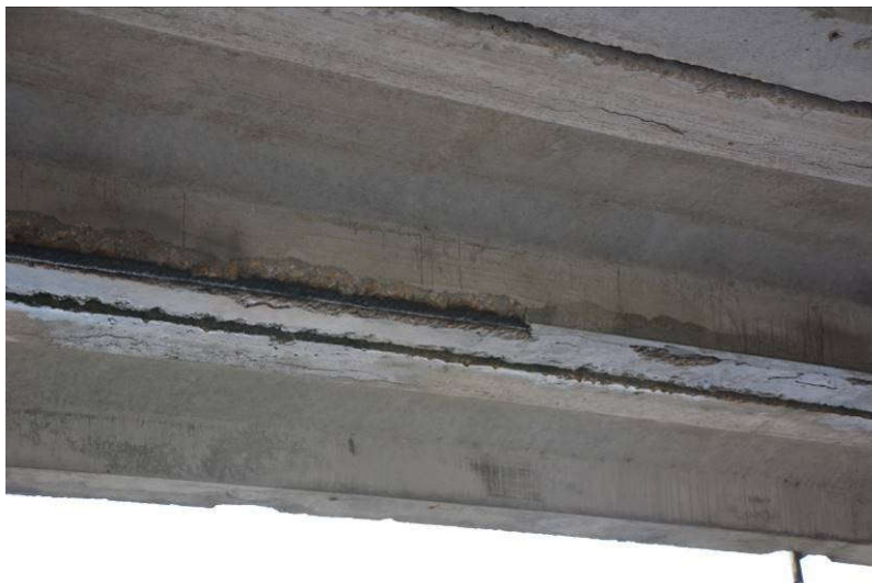
2.2.6. att. Laiduma konstrukcijas plātņu bojājumi (laidums 5-6, augštece). Mitruma caursūkšanās pēdas plātņu sadurvietās, stiegrojuma korozija
