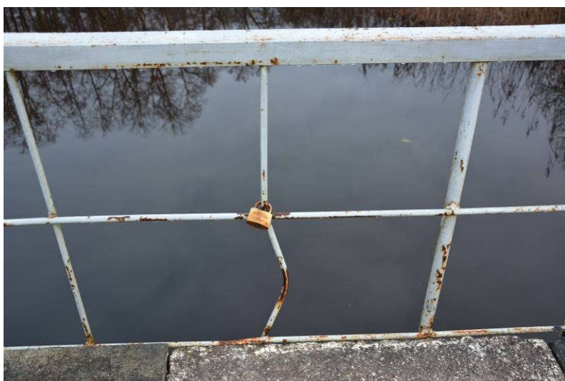
2.1.11. att. Margu konstrukcija korodē, ar defektiem (lejtece, laidums 2-3)
