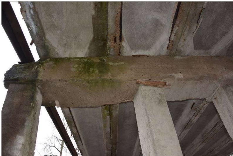
2.4.2. att. Uzkalas gala betona bojājumi, ūdens caursūkšanās un notecējuma pēdas uz uzkalas, palikuši veidņi uzkalas apakšējā daļā (balsts Nr.2, lejtece)
