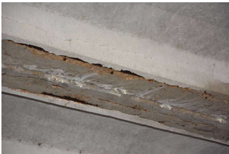
2.2.4. att. Laiduma konstrukcijas plātņu bojājumi (laidums 2-3, plātnes Nr.2 un Nr.3). Mitruma caursūkšanās pēdas plātņu sadurvietās, stieģrojuma korozija, plaisas
