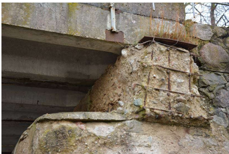
2.3.8. att. Balsta Nr.6 fasāde no augšteces puses. Piebetonētās daļas ārmalā betons sabrūk, atsedzies stiegrojums korodē
