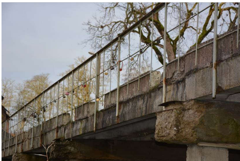
2.2.8. att. Plātņu ārmala notecējusi. Katra otrā laiduma plātne nav malējā, bet vidējā (būvniecības laikā pieļauta atkāpe). Līdzīga situācija abās tilta pusēs
