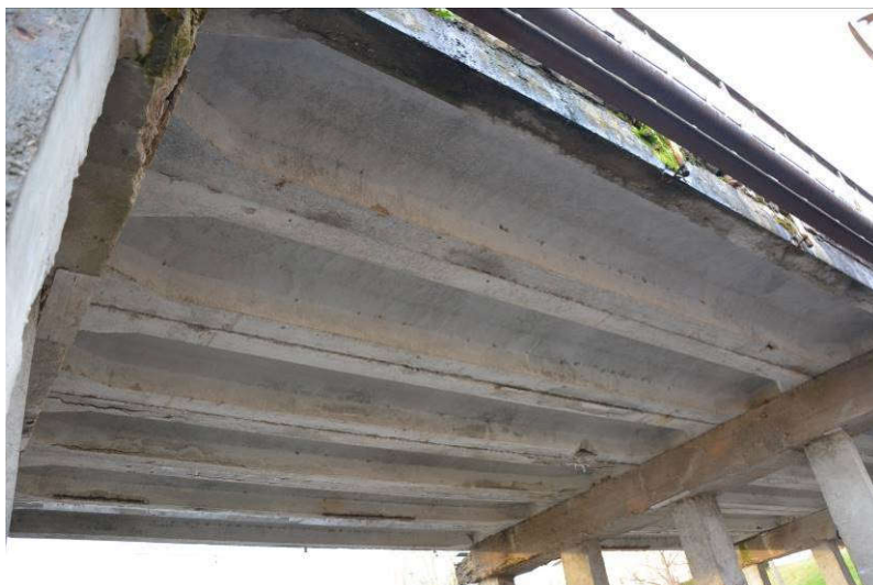
2.2.7. att. Laiduma konstrukcijas plātņu bojājumi (laidums 4-5, skats no lejteces). Mitruma caursūkšanās pēdas plātņu sadurvietās, stiegrojuma korozija, plātņu ārmala notecējusi
