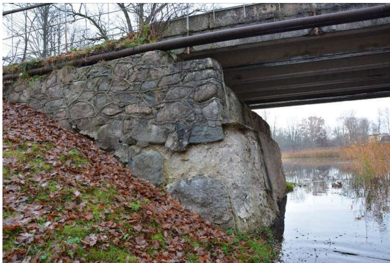
2.3.10. att. Balsta Nr.6 fasāde no lejteces puses. Balsta dekoratīvais laukakmeņu apbetonējums izjūk
