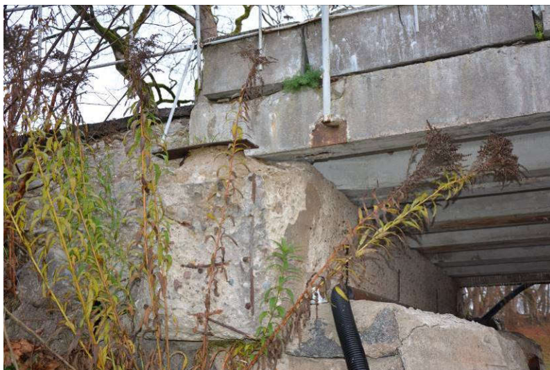
2.3.5. att. Piebetonētās balsta daļas ārējā betons izjūk, atsedzies stiegrojums korodē (balsts Nr.1, augštece)
