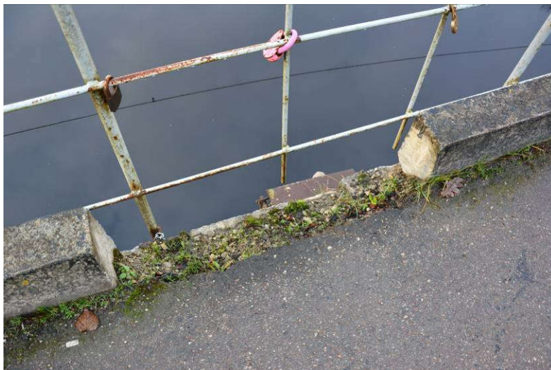
2.1.10. att. Trūkst betona apmale (augštece, virs balsta Nr.4)
