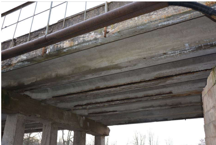
2.2.1. att. Laiduma konstrukcijas plātņu bojājumi (laidums 1-2, skats no lejteces puses). Mitruma caursūkšanās pēdas plātņu sadurvietās, stieģrojuma korozija
