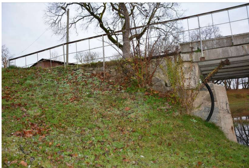
2.3.2. att. Balsta Nr.1 fasāde no augštes puses. Veģetācija. Izirst atbalstsienas konstrukcijas dekoratīvais laukakmeņu mūrējums
