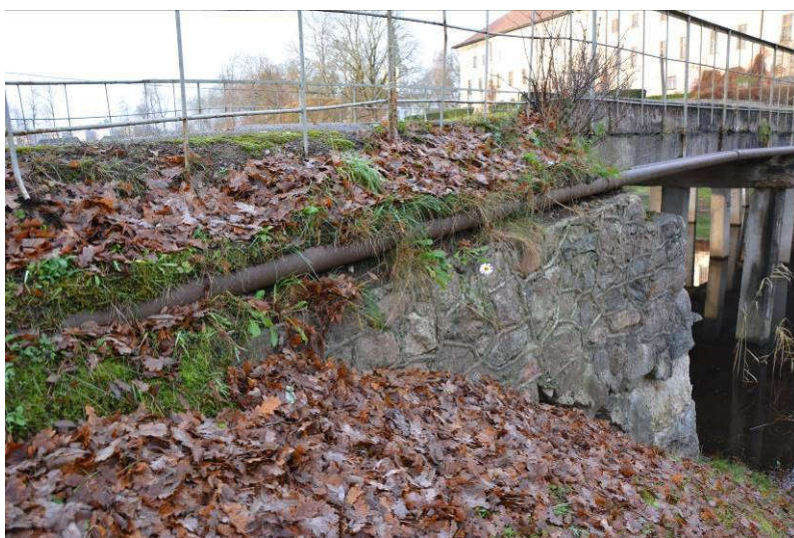
2.3.11. att. Balsta Nr.6 fasāde no lejteces puses. Virsmas ūdens no braucamās daļas nonāk uz balsta virsmas. Izskalojums gar dekoratīvā apbetonējuma robežu (skatīt nākamo att.)
