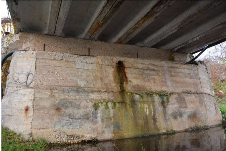
2.3.3. att. Balsta Nr.1 pretskats. Mitruma caursūkšanās uz balsta virsmas
