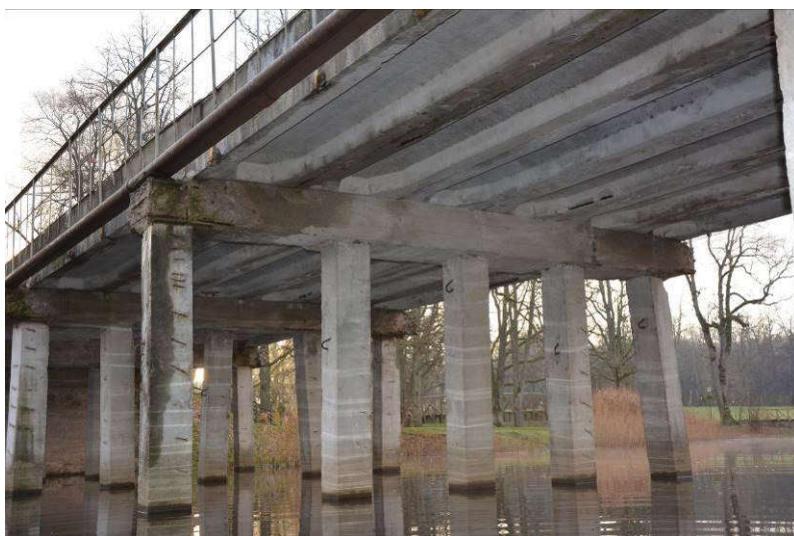
2.4.5. att. Balsta Nr.3 kopskats (augšteces virzienā). Bojāti uzkalu gali, dažviet atsedzies pāļu aptveru stiebrojums, kurš korodē
