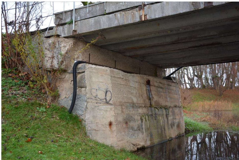
2.3.1. att. Balsta Nr.1 kopskats (skats no augštes). Komunikāciju caurule (elektr.vad.zemspr.) virs balsta. Balsts savulaik apbetonēts, darba šuvju vietās izspiežas gruntsūdens. Piebetonētā daļa mainīgā ūdens līmeņa zonā ar bojājumiem, izskalojas betons
