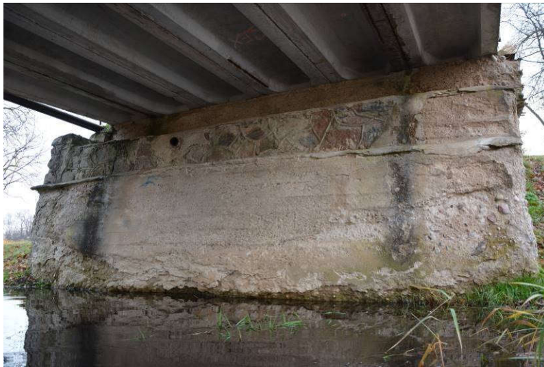
2.3.9. att. Balsta Nr.6 pretskats. Betona ārējās virsmas sadrupšana, mainīgā ūdens līmeņa zonā betons izskalojas
