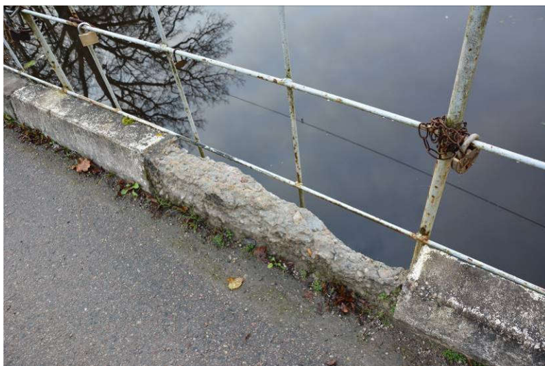
2.1.9. att. Betona apmale sabrukšanas stadijā (augštece, laidums 3-4)
