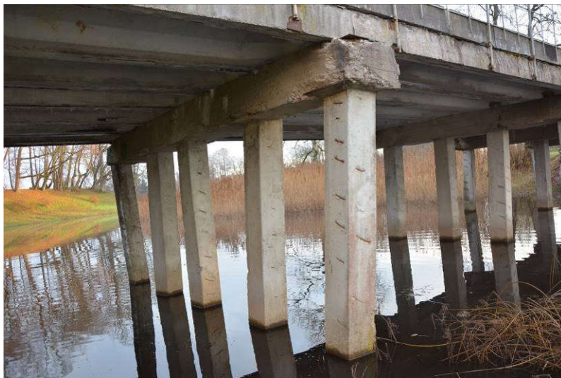
2.4.4. att. Balsta Nr.2 kopskats no augšteces puses. Uzkalas gala bojājumi, atkāpes no vertikālā stāvokļa malējiem pāļiem (būvniecības neprecizitāte)
