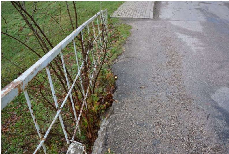
2.1.7. att. Izskalojums virs atbalstsienas (augštece, kreisais krasts). Nav sakārtota ūdens atvade tilta pieejās, a/b sega nomaļes zonā sabrukusi, virsmas ūdens nokļūst uz mūra atbalstsienas
