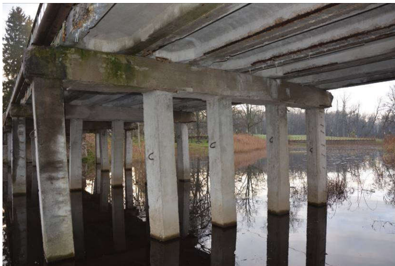
2.4.1. att. Balsta Nr.2 kopskats (augšteces virzienā). Bojāti uzkalu gali, dažviet atsedzies pāļu aptveru stiegrojums, kurš korodē
