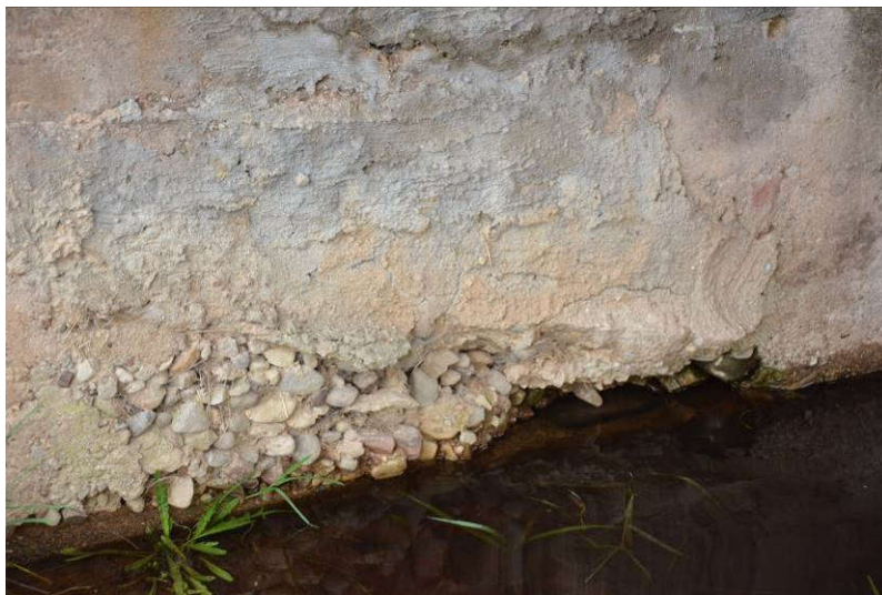
2.3.4. att. Betona bojājumi mainīgā ūdens līmeņa zonā
