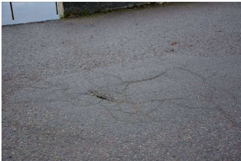
2.1.6. att. Asfaltbetona sega plaisaina, ar iesēdumiem
