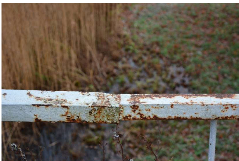
2.1.12. att. Margu korozija (roktura tuvplāns)
