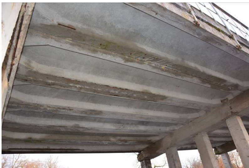
2.2.3. att. Laiduma konstrukcijas plātņu bojājumi (laidums 2-3, skats no augšteces puses). Mitruma caursūkšanās pēdas plātņu sadurvietās, stieģrojuma korozija
