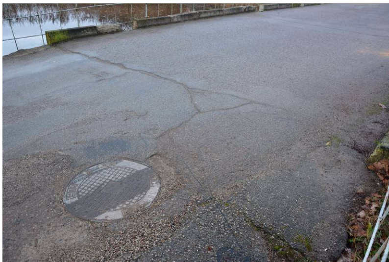
2.1.4. att. Pirms balsta Nr.6 (labais krasts) komunikāciju lūka, asfaltbetona sega ar iesēdumiem, plaisaina, nelīdzena
