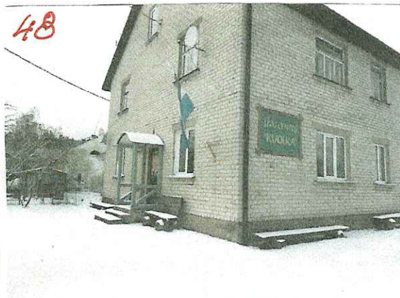
48 FASĀDES TEHN. STĀVOKĻIS DAĻĒJI APŪMĒRINŌS.
