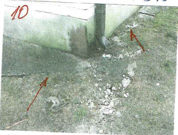
10 BETONA APMALES IZDRUPUŠAS
